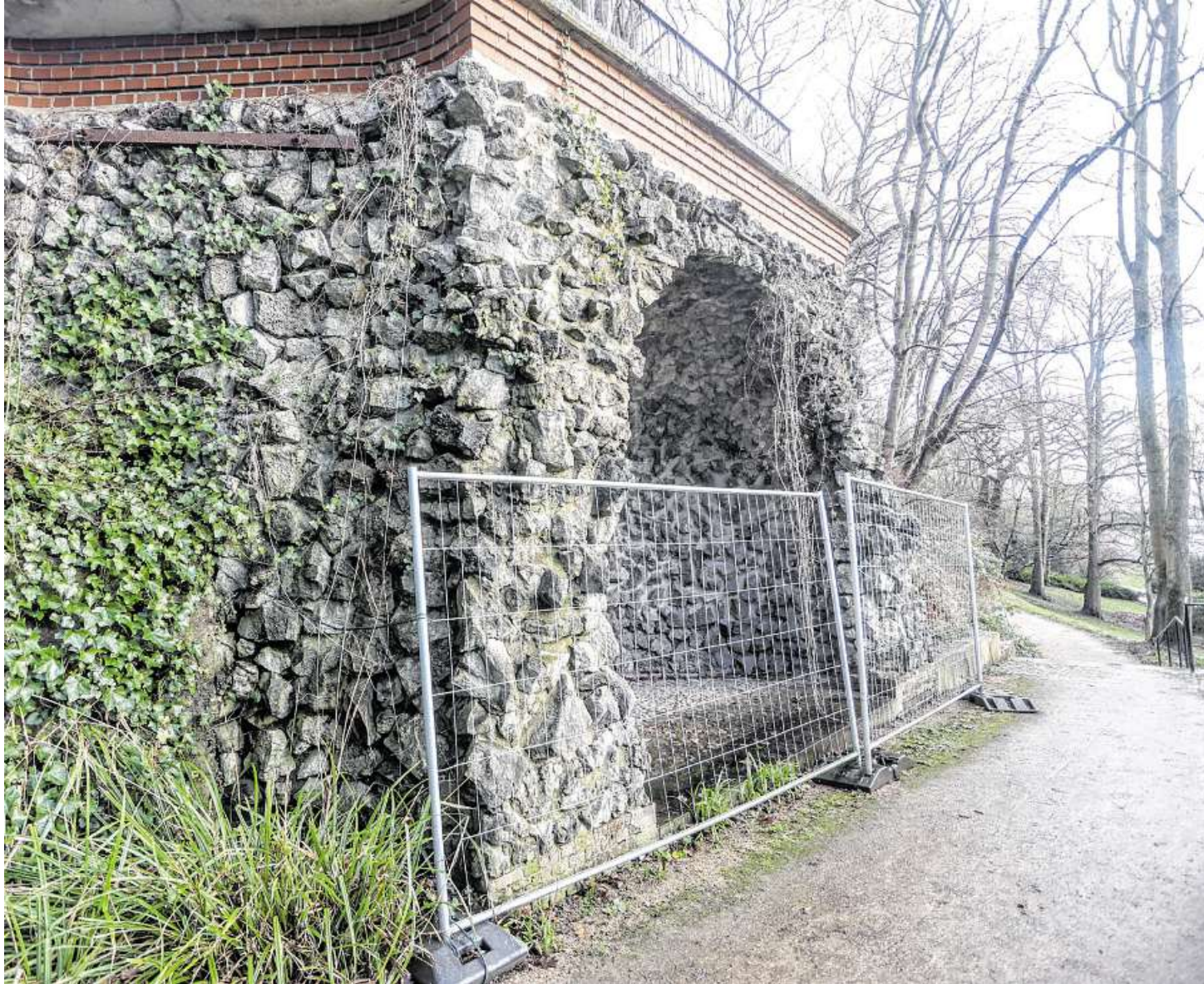
Der gesperrte Balkon und die darunter liegende, ebenfalls gesperrte Albrechtsgrotte in Knoop's Park sollen saniert werden. FOTO: CHRISTIAN KOSAK
