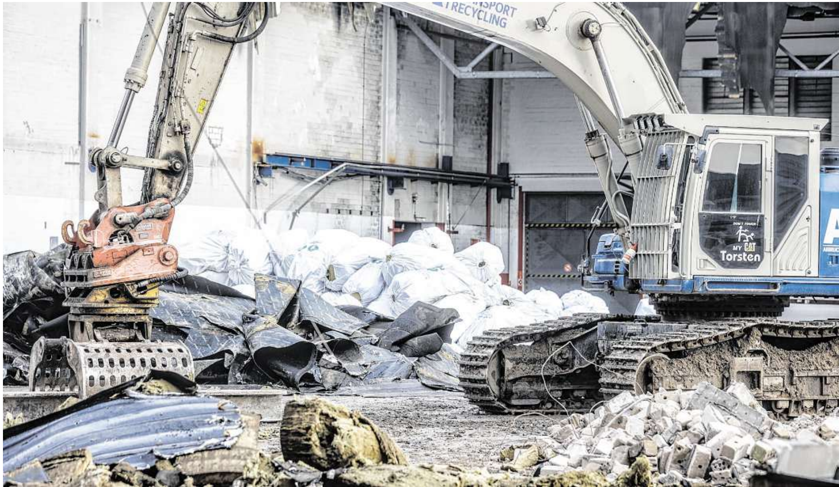
Abriss mit Bagger: Von einer Halle im Kämmerei-Quartier sind nur noch die Sei- tenwände übrig. FOTOS: CHRISTIAN KOSAK
